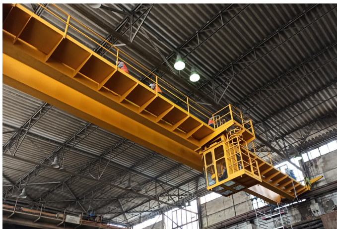
Jeřáb mostový dvounosníkový 5t - 22,5m s kabinou - Slévárna HEUNISCH Brno s.r.o.
